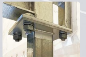
フランジ構造の接続部
