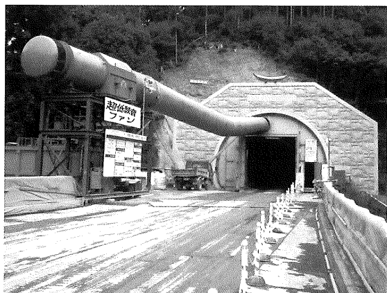
図1 トンネル工事換気ファン
