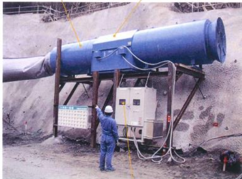
ファンを自在にコントロールする インバータ盤。
